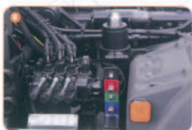
Centralizarea comenzilor sistemului (la exterior): conectori pneumatici și electrici.
